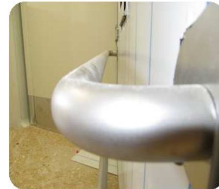
Protecciones inox en las puertas
