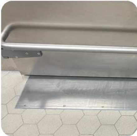
Suelo extendido en inox
