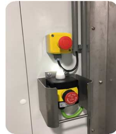
Pulsador de alarma y paro en el interior con sirena incorporada
